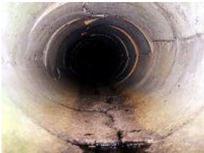
Beschreibung: Rohrleitung Risse
