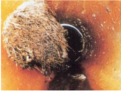
Beschreibung: Rohrleitung Wurzeleinwuchs
