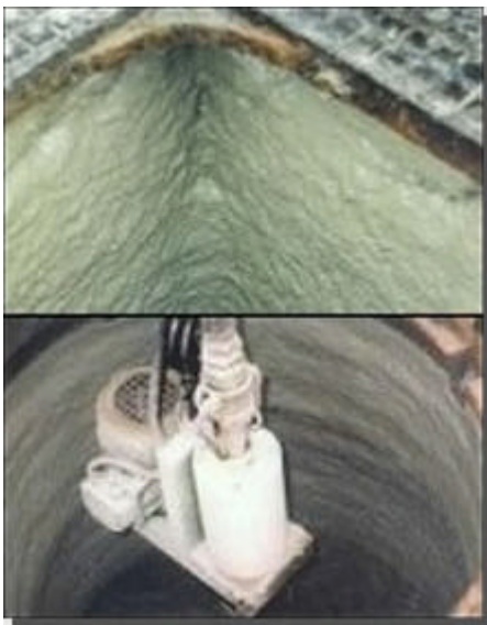
Beschreibung: Auflagefläche Gitterrost Schlammfang korrodiert
