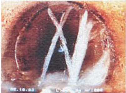
Beschreibung: Rohrleitung Wassereinbruch
