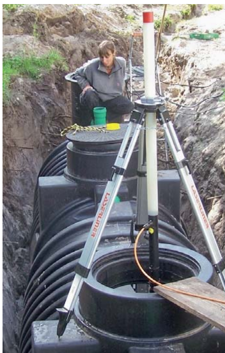
Eine nicht vollständig verfüllte Baugrube eines Kunststoffbehälters ermöglicht keine ordentliche Pegelabfallmessung. Bild 5
