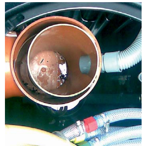
In diese PROBENAHME-VORRICHTUNG kann keine Sperrblase eingebaut werden: Die Dichtheitsprüfung nicht durchführbar! Bild 6
