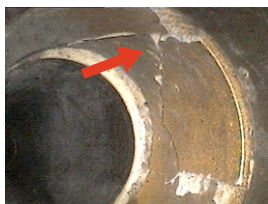
Riss im Anschluss
