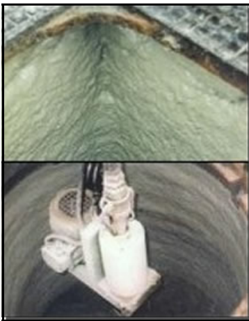
Beschreibung: Auflagefläche Gitterrost Schlammfang korrodiert
