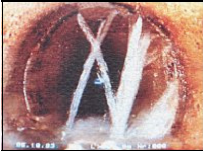
Beschreibung: Rohrleitung Wassereinbruch Rohrleitung wurde saniert und ist dicht. (siehe Prüfprotokoll vom 16.03.2007)
