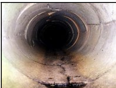
Beschreibung: Rohrleitung Risse
