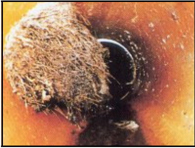
Beschreibung: Rohrleitung Wurzeinwuchs
