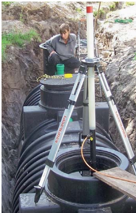
Eine nicht vollständig verfüllte Baugrube eines Kunststoffbehälters ermöglicht keine ordentliche Pegelabfallmessung. Bild 5
